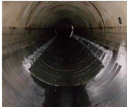
Abb. 25: Abwasserwärmetauscher im Kanal (Quelle: Fa. Uhrig)
