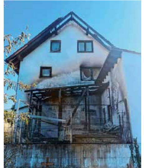
Die Gebäuderückseite nach dem gelöschten Brand. Bild: Feuerwehr
